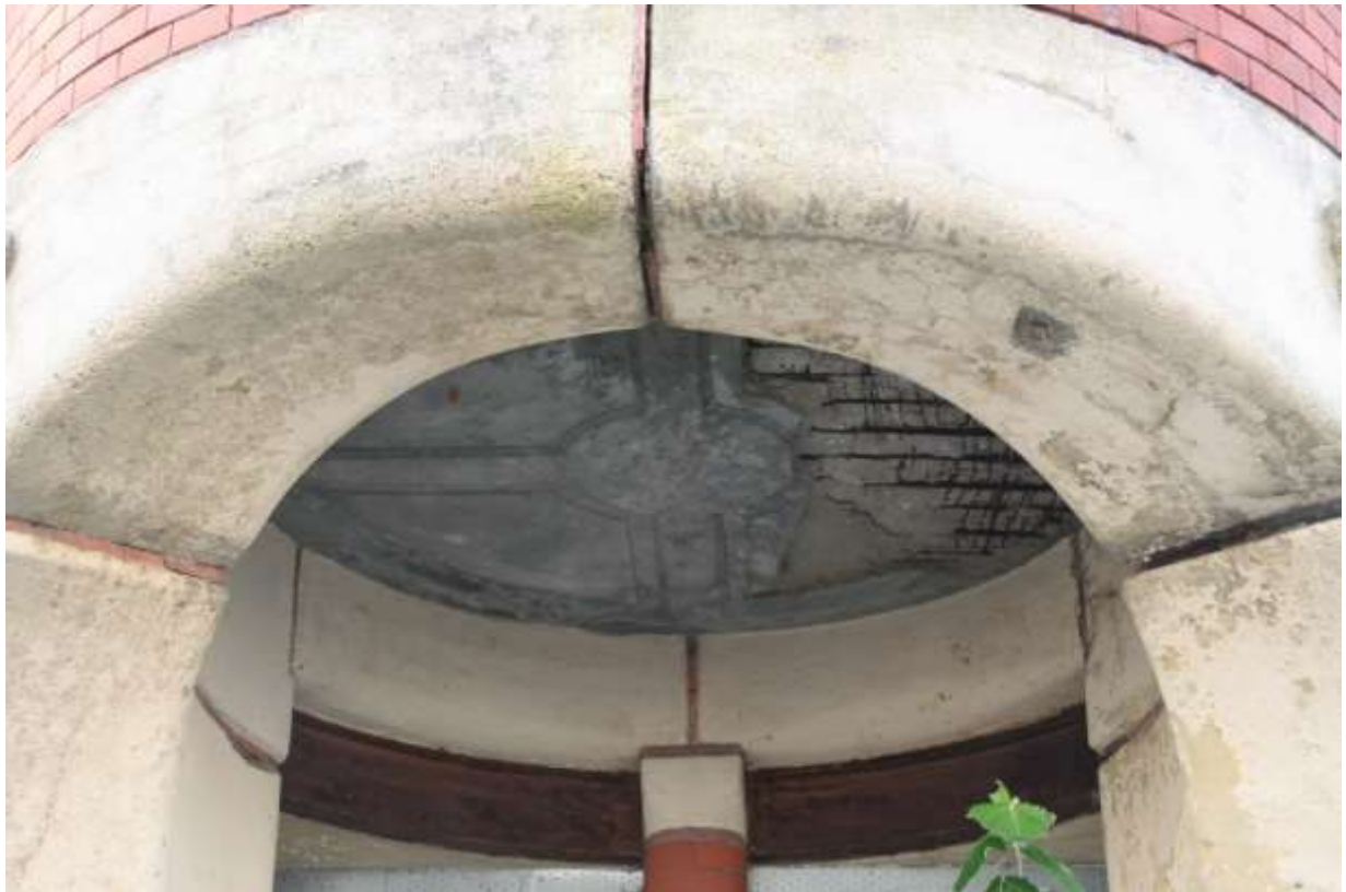
Afb. 3 Detail voorgevel; schade balkon.
